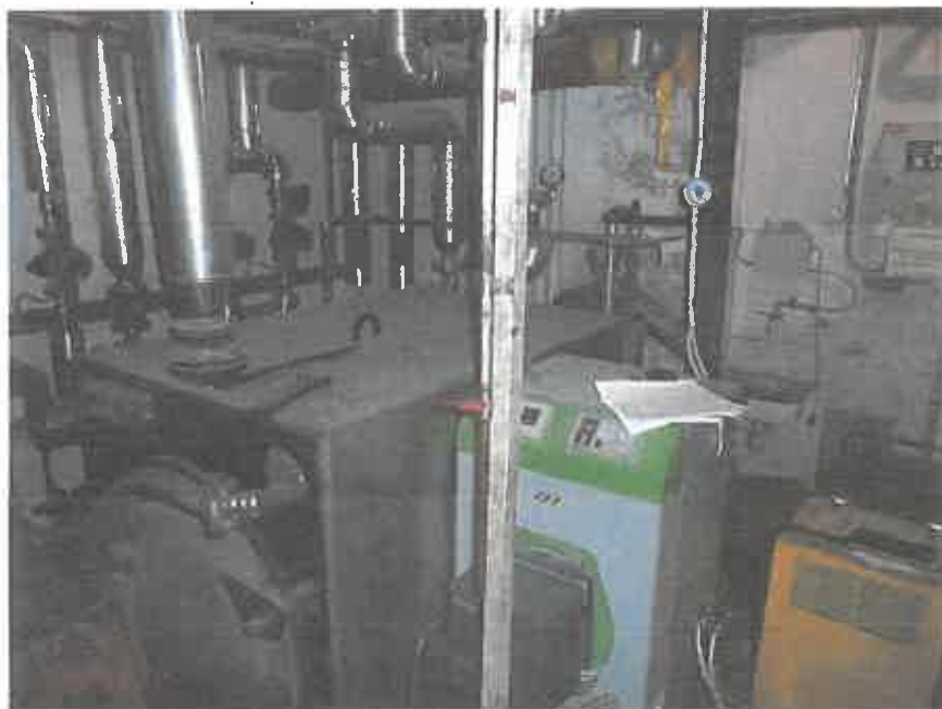
Obstoječa kotla s oljnima gorilnikoma
