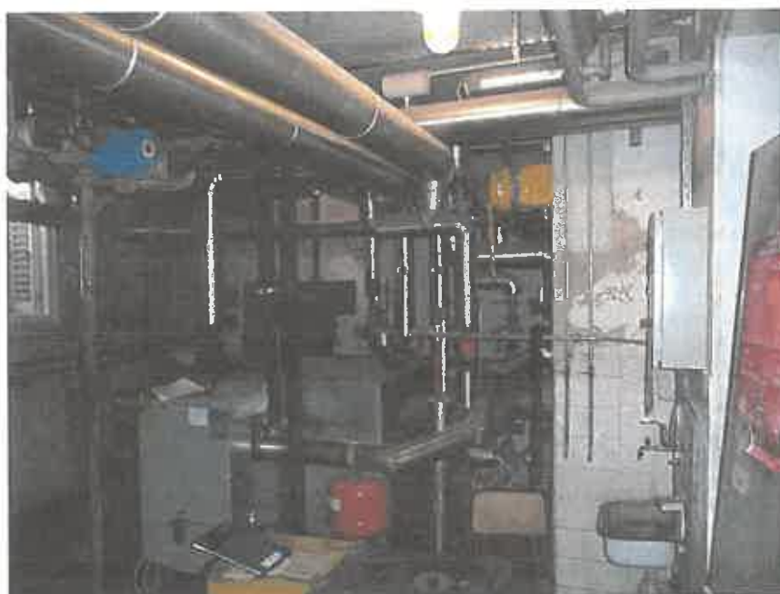
Obstoječa kotla z oljnimi gorilniki
